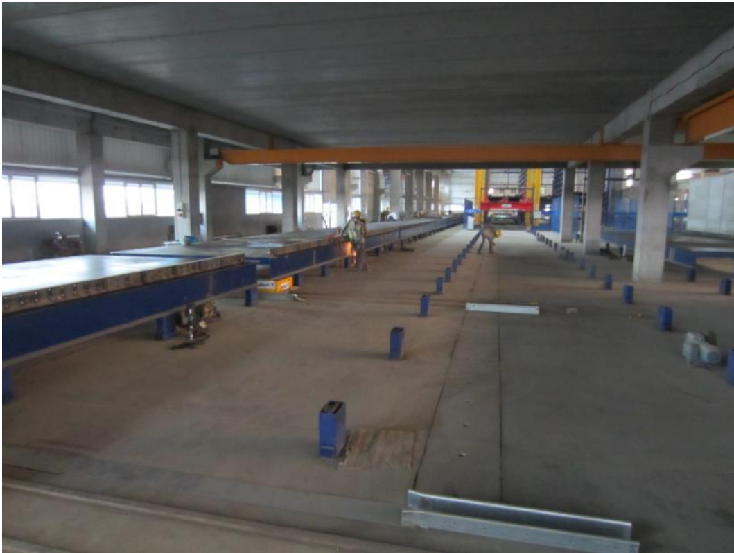
Fig. 11: 托盘穿过固化室直接运至抹平工作站下方
