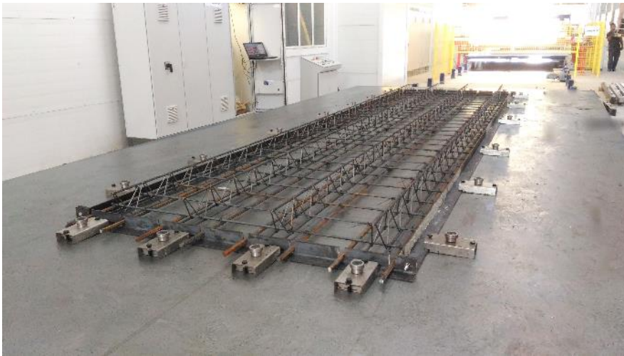
Fig. 3: 数控型绘图机SMART PLOT在模板系统和注入钢筋混凝土之前按照1:1 比例绘制轮廓线
